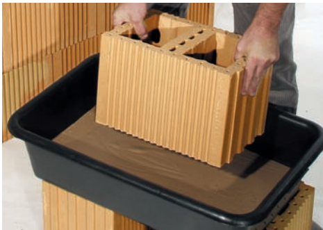
1. Plan-Füllziegel wird in Dünnbettmörtel getaucht, so dass die Lagerfläche mit Mörtel benetzt ist
